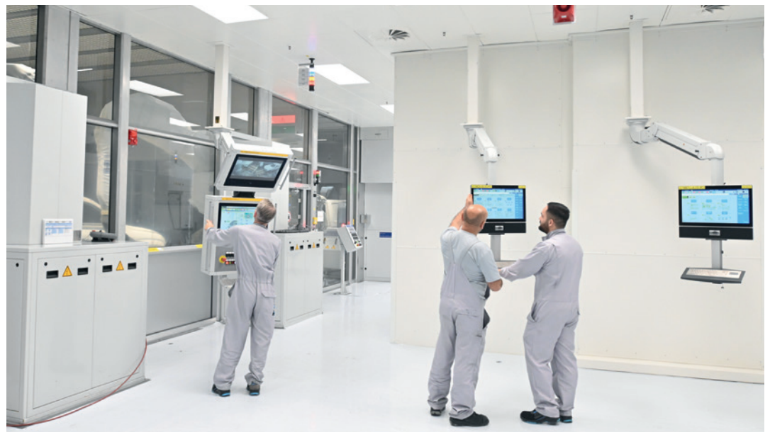
Eine der Steuerzentralen der neuen Decklackanlage: Die Bedienelemente sind höhenverstellbar und damit auch für Beschäftigte im Rollstuhl zu bedienen.
